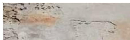
Skade i overfladen
